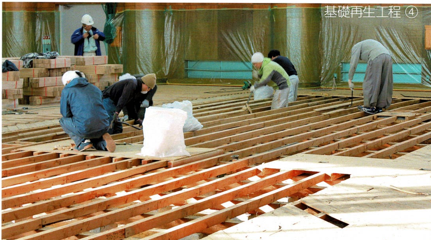
捨て張り板を完全撤去後、構造用合板を全面に張ります
