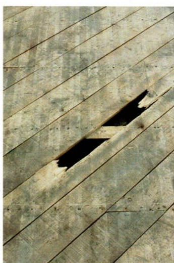
捨て張り板材の欠損 1
