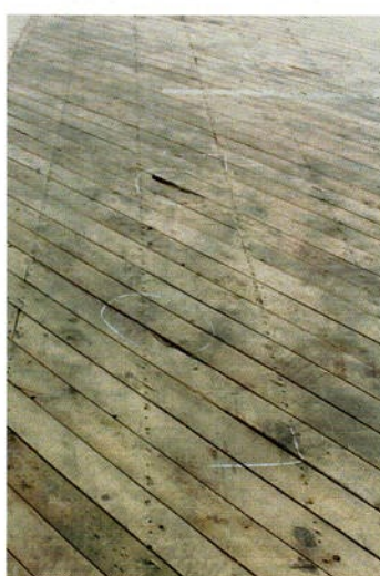
捨て張り板材の欠損 2
