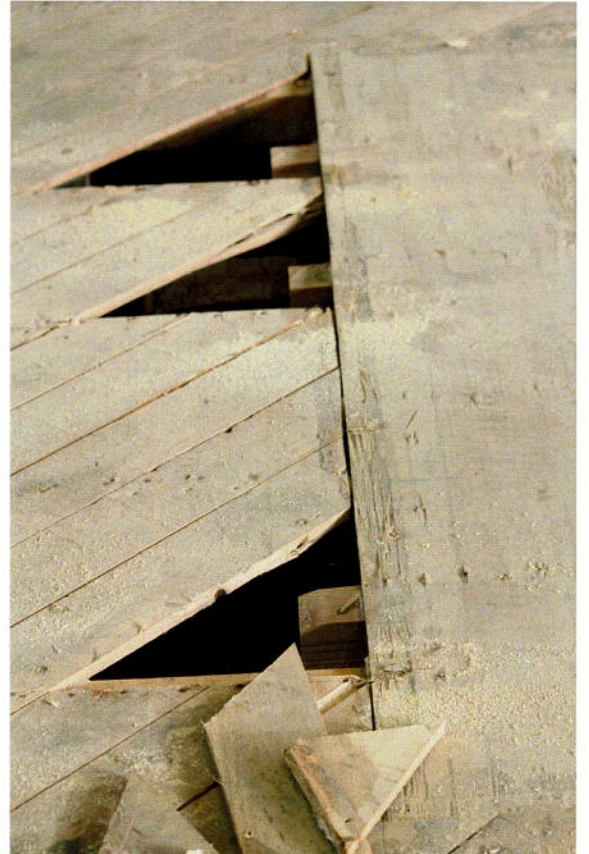
根太不足の箇所を確認
