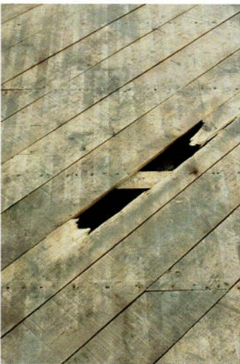
捨て張り板材の欠損 1
