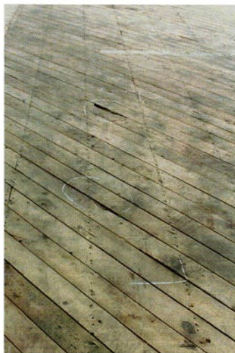
捨て張り板材の欠損 2
