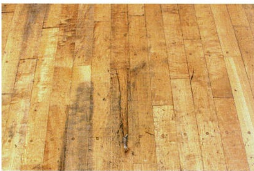
大きく裂けた床材
